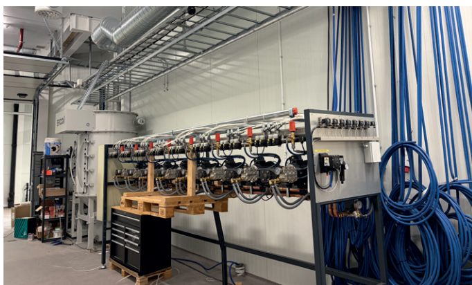
Dive Ins automatiserte vaskesystem bygger på innfløkt teknologi både under og i bygget.
