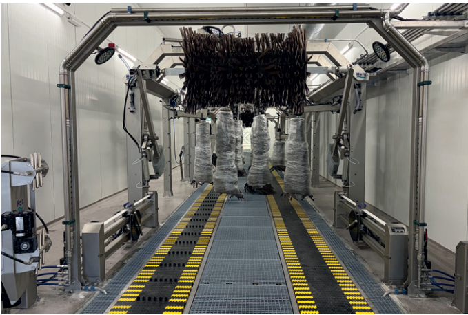
I vasketunnelen trekkes bilene frem på et bånd, og er innom en rekke stasjoner før de triller ut skinnende rene.
